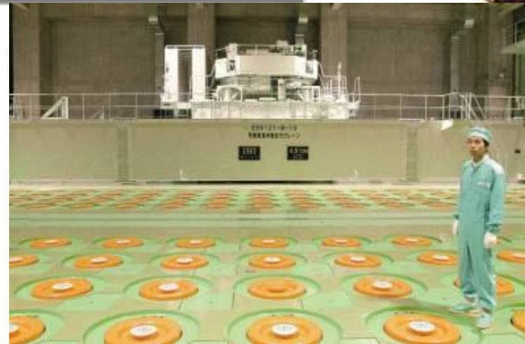
高レベル放射性廃棄物貯蔵管理センター (写真提供：日本原電(株))
